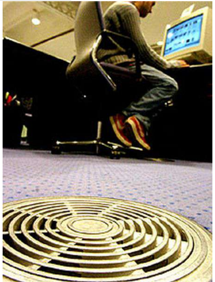
Salida de la conducción de aire acondicionado en un centro de trabajo. JOAN SÁNCHEZ
